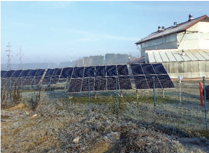
Oczyszczalnia ścieków Drzonów
