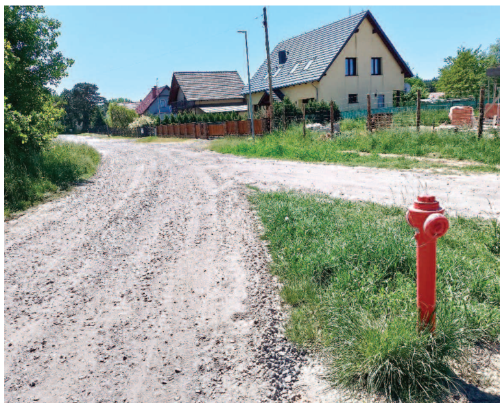
Budowa sieci wodociągowej w ul. Diamentowej, Brylantowej, Polnej i Spokojnej w m. Słone – etap I
